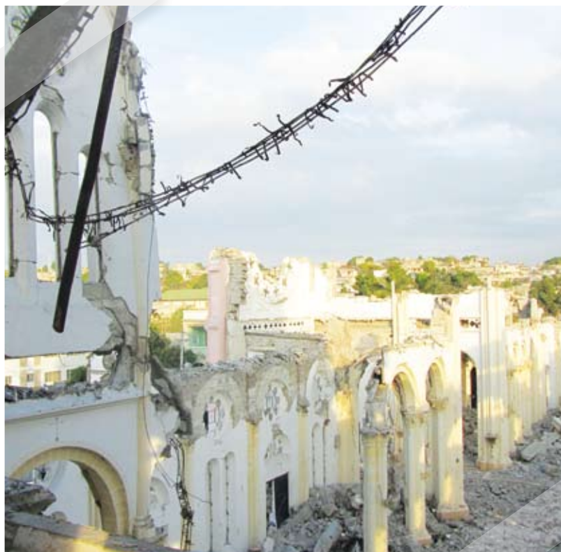
Cathédrale de Port-au-Prince détruite par le séisme du 12 janvier 2010
